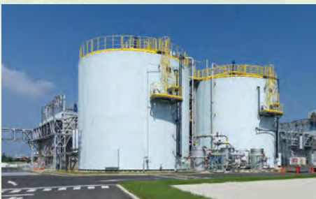
ニューエナジーふじみ野(株) バイオガス発電プラント
