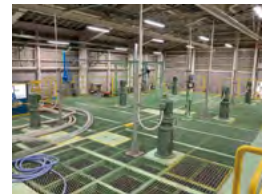
更新後の坑廃水処理施設(小真木鉱山)
