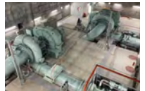
小又川新発電所 建屋内部 (水車、発電機)
