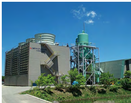
大沼地熱発電所
