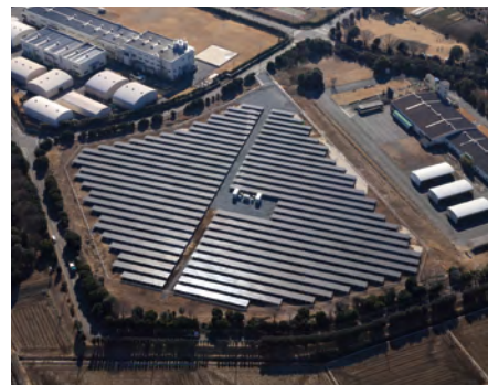
真壁太陽光発電所
