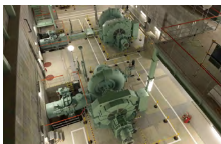
小又川新発電所(水車発電機)
