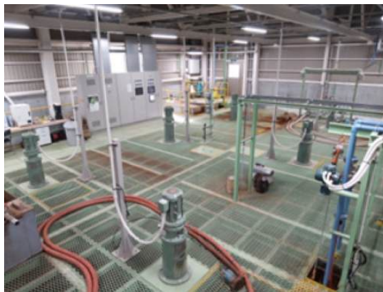
更新後の坑廃水処理施設（尾去沢鉱山）
