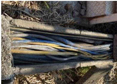
▲線路脇に敷設されている 信号ケーブル
