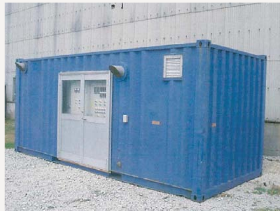
ガス状ダイオキシン類分解装置
