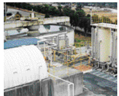
岐阜工場の排水処理設備 (岐阜県美濃加茂市)
