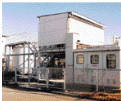
筑波製作所の排水処理設備 (茨城県石下町)
