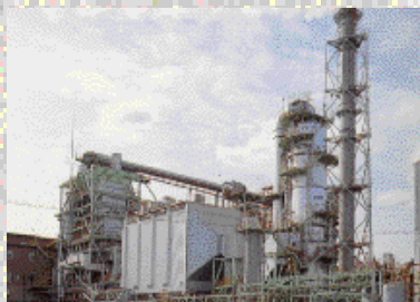
九州工場(セメント生産・福岡県苅田町)の排熱発電設備(24,000kW)
