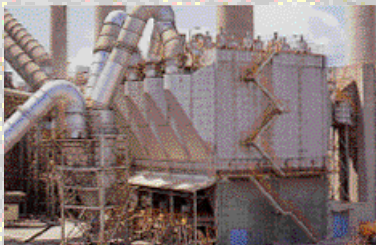
大気汚染防止用排煙処理設備 (九州工場、セメント生産、福岡県苅田町)
