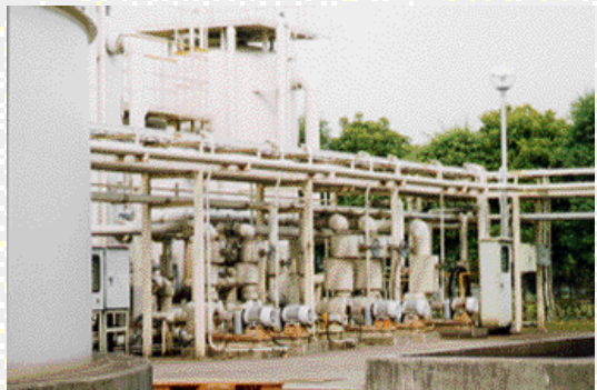
結城工場排水処理設備 (アルミ缶製造、茨城県結城市)
