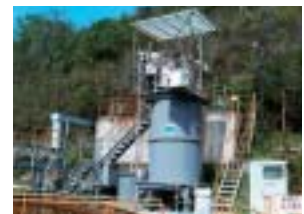
排水処理プラント
