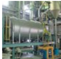
タングステンリサイクルプラント 日本新金属(株)秋田工場
