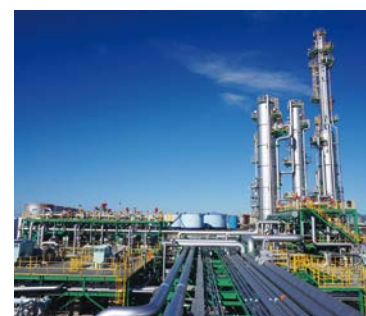
苫小牧CCS実証試験プラント
