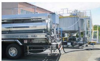
設置した廃液回収用タンク
