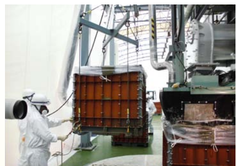
セメント固型化処理設備の操業風景
