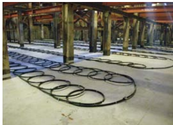
鉄道トンネル下床版に敷設したコイル型水平方式の熱交換器
