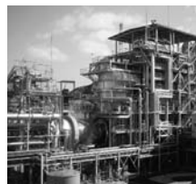
直島製錬所 有価金属リサイクル設備
