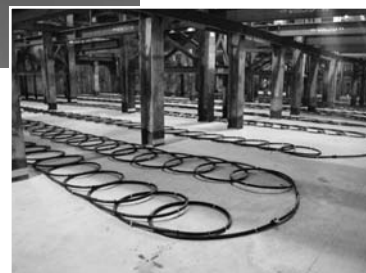
鉄道トンネル下床版に敷設したコイル型水平方式の熱交換器 夏季は駅のホームの熱を放熱し、冬季には採熱してホームの暖房に役立てる
