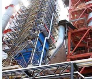
烟台工場の排熱発電設備
